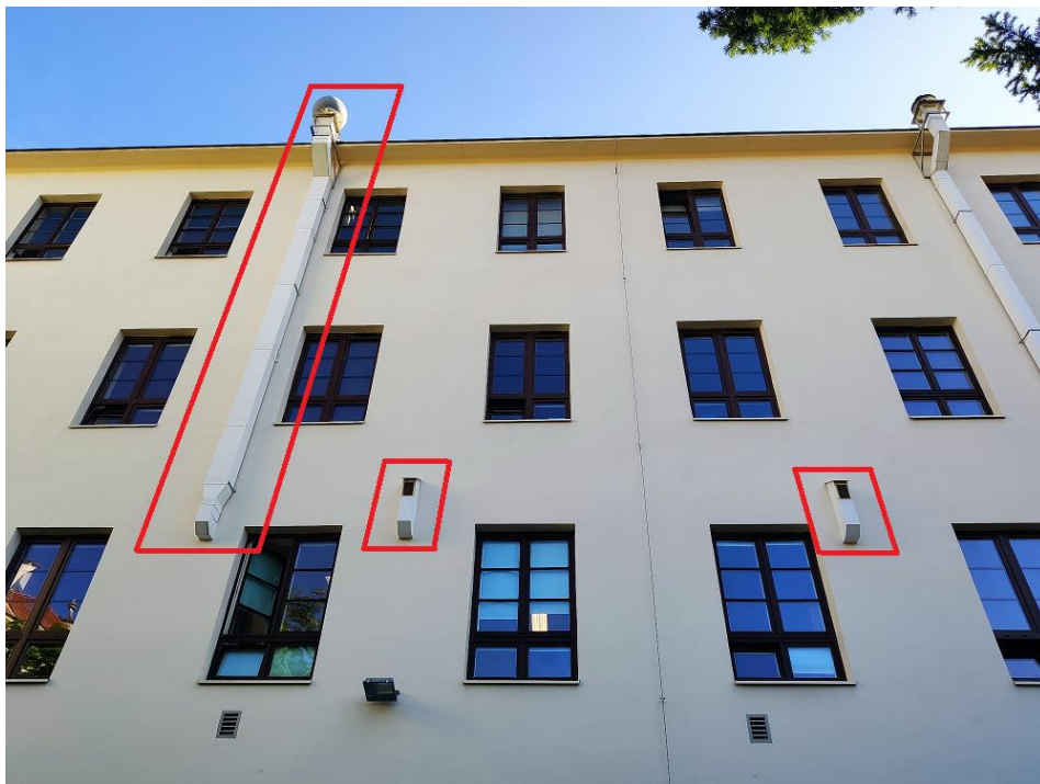
Zdj. 2 Widok elewacji (kanał wywiewny + dwa kanały nawiewne)
